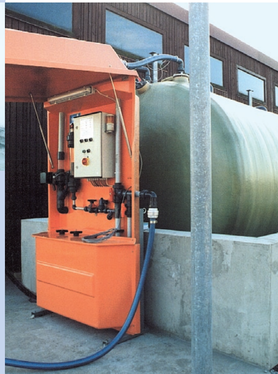
Automatische Misch- und Auftankstation Solmix
